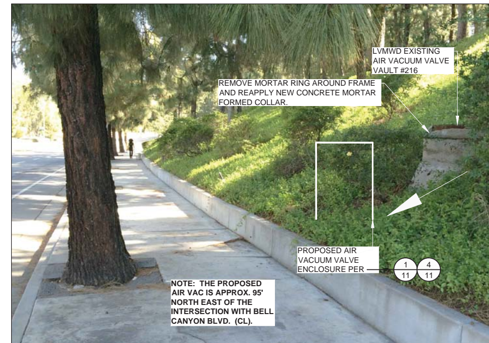
AIR VAC # 216 SITE PHOTO SCALE: N.T.S.
